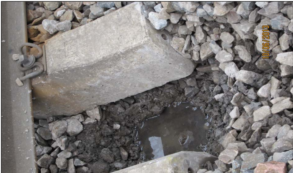
Abb. 11: Schürfstelle an der Entgleisungsstelle in km 76,950
