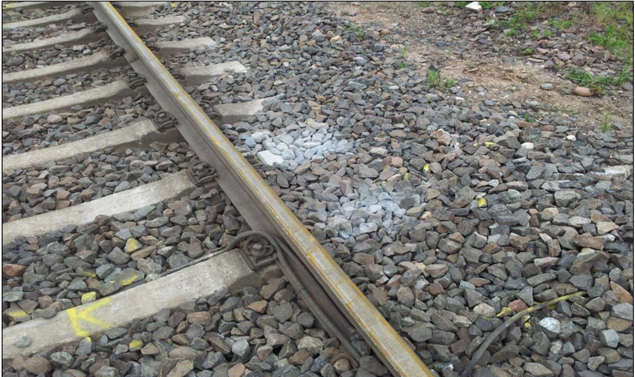
Abb. 10: „weiße Stellen“ im Schotter deuten auf Störstellen im Gleis hin
